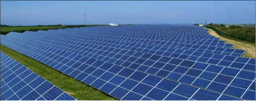
Şekil 12: Fotovoltaik teknoloji ile elektrik üreten paneller.
